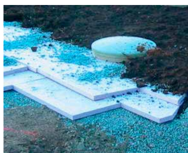
Frostsikring av tanker
