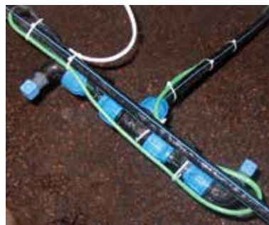
Varmekabel i biofilteret
