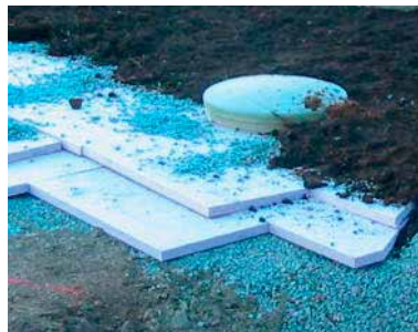
Frostsikring av tanker
