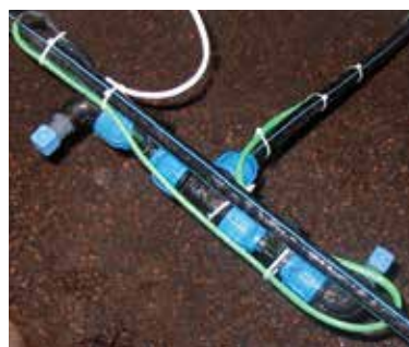
Varmekabel i biofilteret
