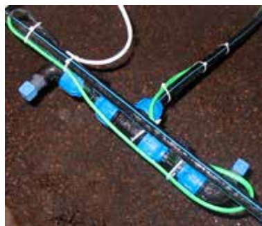
Varmekabel i biofilteret
