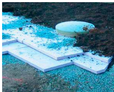
Frostsikring av tanker
