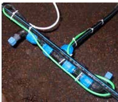
Varmekabel i biofilteret
